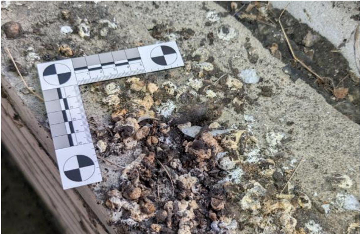
Abb. 5: Kotpuren und organische Reste unterhalb potenzieller Brut- und Aufenthaltsbereiche im östlichen Gebäude. Die Befunde sind als Hinweis auf eine wiederholte Nutzung des Gebäudes durch gebäudebrütende Vogelarten zu bewerten.
